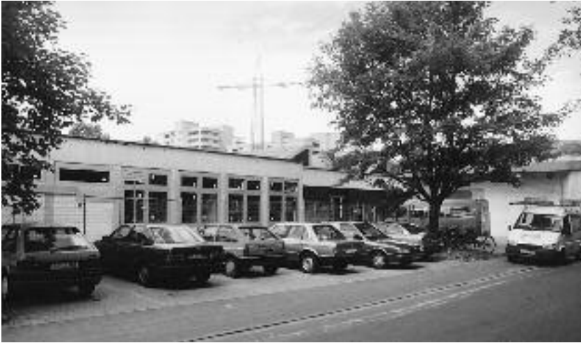
Die Werkstatt für Behinderte am Scheifenkamp befand sich im Sommer dieses Jahres noch im Umbau
